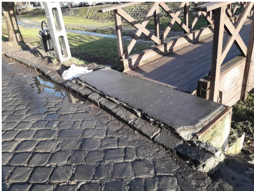
Jobb parton lévő járdacsatlakozás
