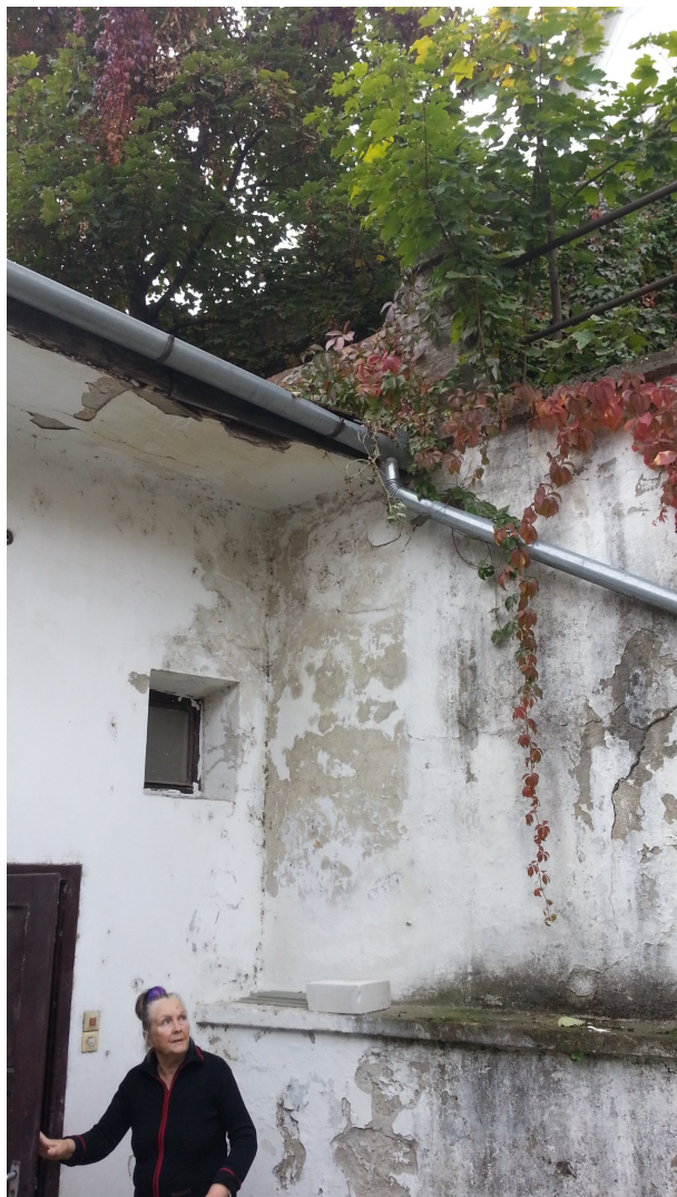
Az udvari támfalon vizesedés látszik a vízszigetelés hiányzik, avult.
