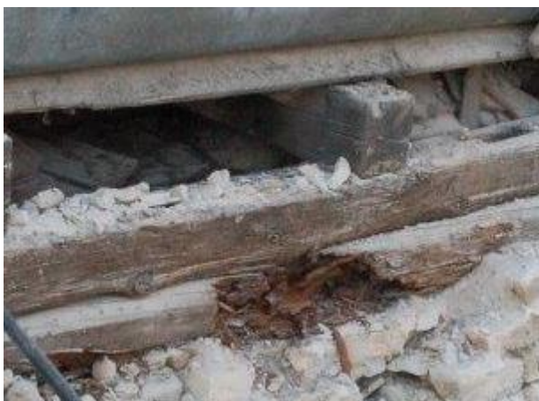
7. kép teljes keresztmetszetben tönkrement sárgerenda
