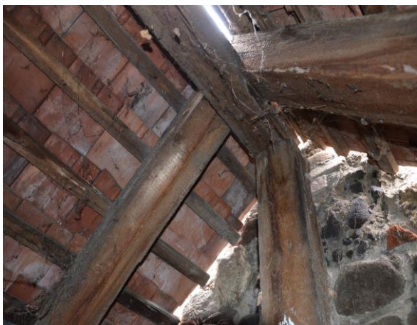
12. kép beázott taréjszelemen
