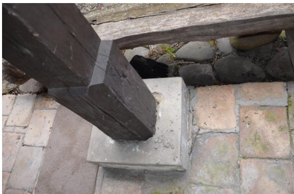
9. kép szakszerűtlen oszloprögzítés, talajkontaktusból eredő biológiai kár
