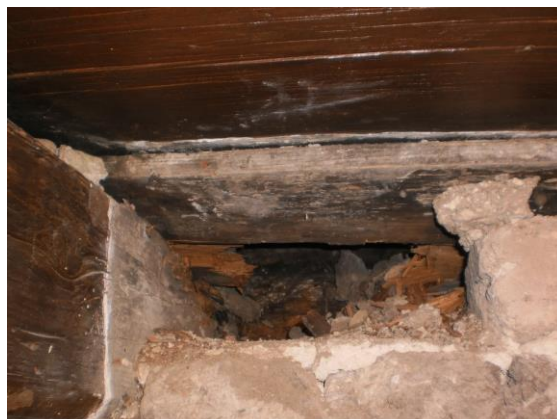
15. kép károsodott gerendavég és deszkázat
